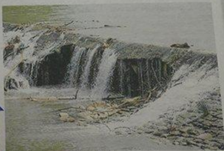
Socavón en la presa de Santa Engracia.
