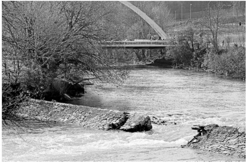
Imagen de la presa (de piedra) rota en su mitad que ha reducido el nivel del río aguas arriba.
