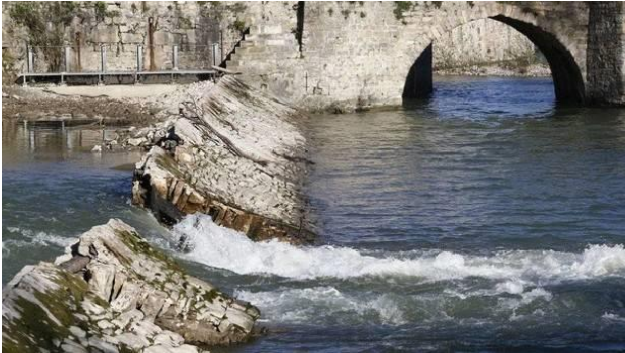
Vista de la presa de Santa Engracia, rota parcialmente. (PATXI CASCANTE)
