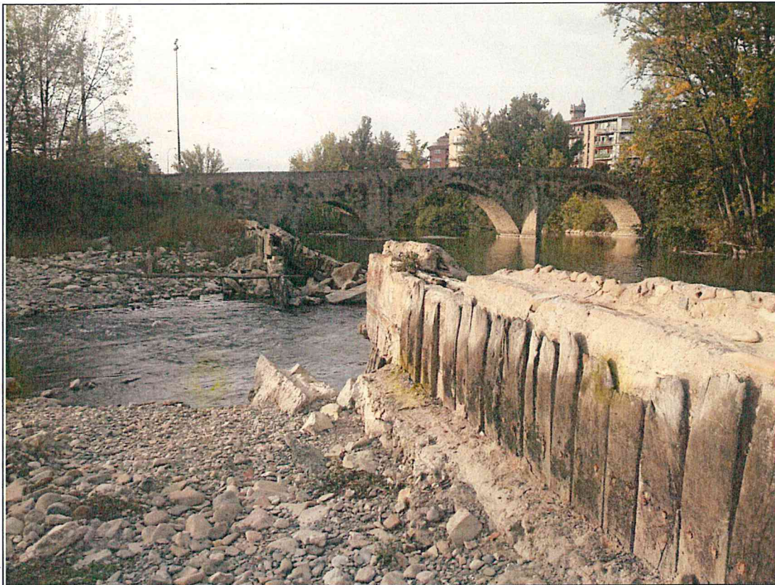
.- En primer plano, la presa de Santa Engracia derruida, dejando a la vista en su parte central un armazón interno de madera. Al fondo, el puente de Santa Engracia. Octubre 2018. Foto David Alegría.
